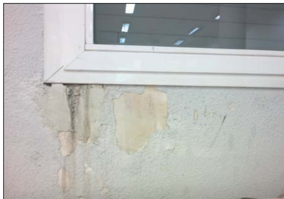
Fig. 1: Lesiones por filtración en esquina inferior de ventana
